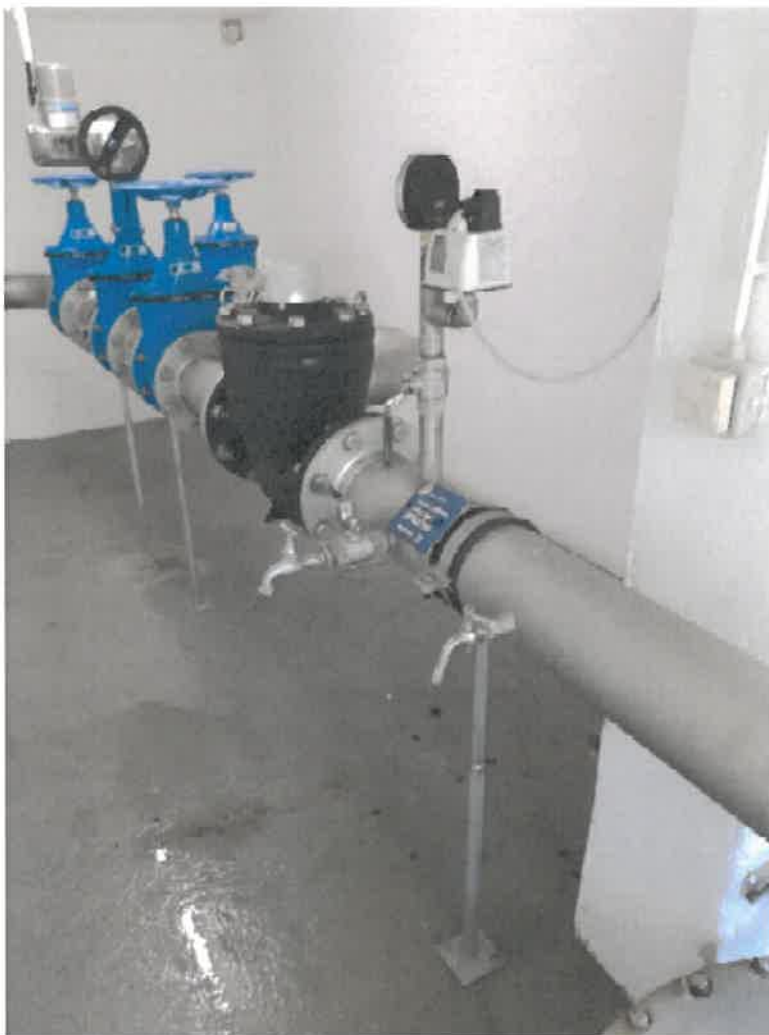
Abb. 15: Entnahmeleitung des Tiefbrunnen Schwendau im Brunnenhaus.
